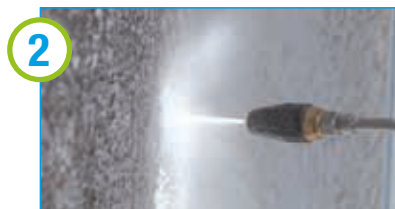
2 Einfaches Reinigen der Fassade: Mit einem Hochdruckreiniger entfernen Sie optimal alle haftungsbeeinträchtigenden Substanzen, Farbpartikel und Restwirkstoffe.
