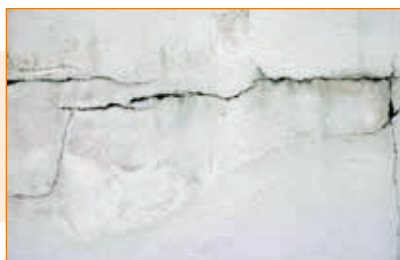
Putzrisse Kategorie B (vom Putzträger ausgehend)
